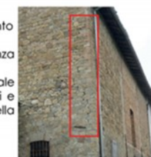
b. lesione tra muro soggetto a ribaltamento e muro ortogonale
